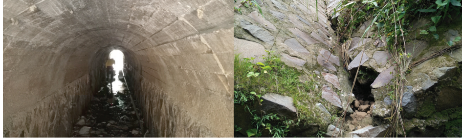
Figura 7. Fotografías de la cama de agua dañada y el desprendimiento en la bóveda Cruz Verde, Atiquizaya.
