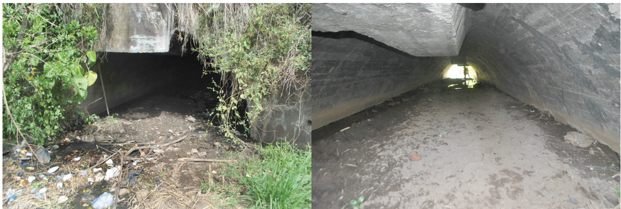
Figura 6. Fotografías de la entrada y del azolvamiento de la bóveda Barranca Honda, El Refugio, Ahuachapán.
