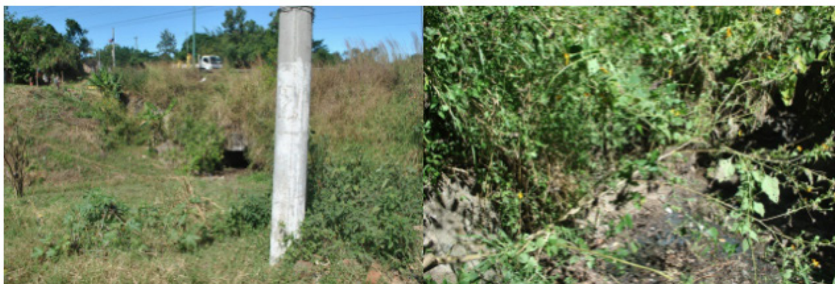
Figura 3. Fotografías de los accesos a la bóveda de Quebrada Honda, municipio de Ahuachapán y a la bóveda de Turín, municipio del mismo nombre; ambas en el departamento de Ahuachapán.
